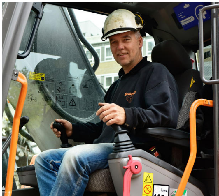
KRAANMACHINIST JACOB TIEMES TREKT HET GEBOUW - STUKJE BIJ BEETJE - UIT ELKAAR MET DE MACHINALE GRIJPARM. DAAR KOMT VEEL VERANTWOORDELIJKHEID BIJ KIJKEN. 'JE WILT NIET DAT ER IETS ONVERWACHTS INSTORT.'
